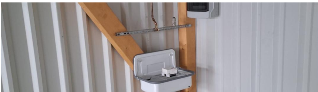
Waschbecken mit Wasseranschluss
