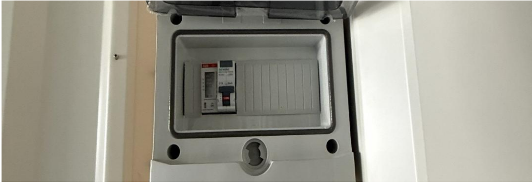
Eigener Stromzähler je Einheit
